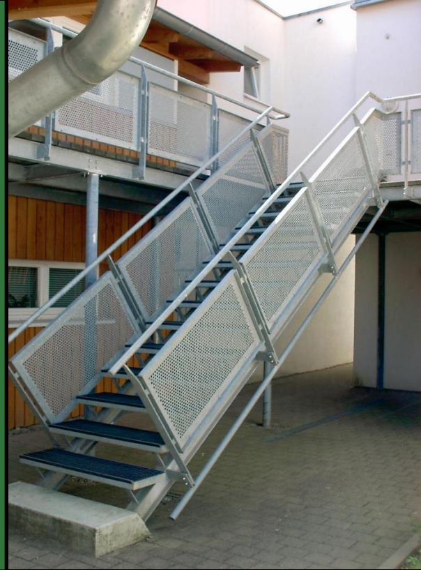
U- Wangentreppe Flachstahlstützen- geländer mit Lochblechfüllung und Rundrohrhandlauf Trittstufen aus Gitterrost mit Gummiauflager
